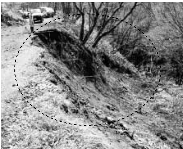
4月11日から12日に発生した豪雨災害現場
