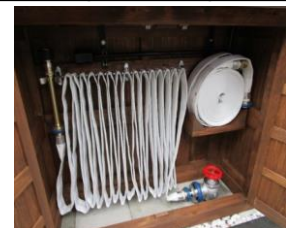
伝建地区の新設消火栓 整備後
