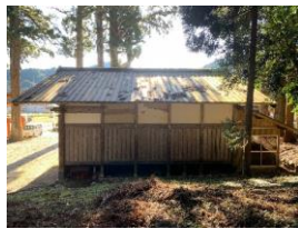
舞台屋根修繕前
