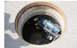
▲電線共同溝(職人町)
