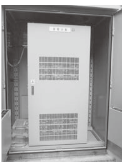
災害時に機能する蓄電池
