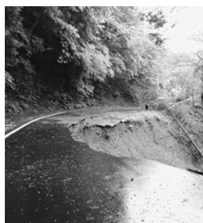
林道白谷谷線の被災状況
