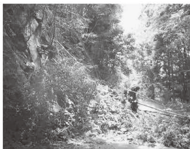
大和 大間見2林道 災害状況(発生当時)
