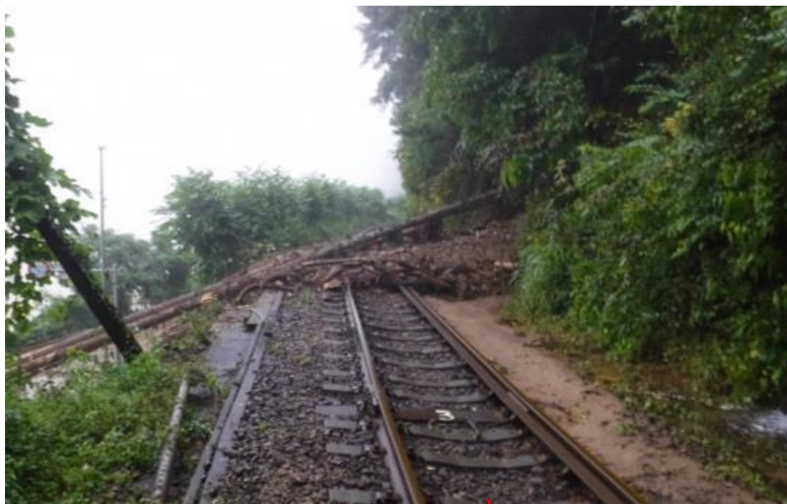
災害発生状況 (美濃市曾代地内)
