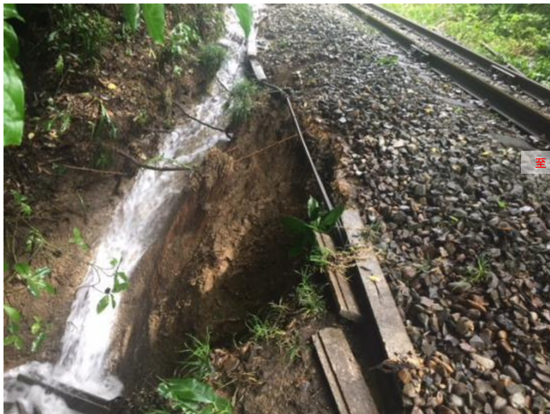
雨水により路肩法面が一部崩壊 (美濃市曾代地内)
