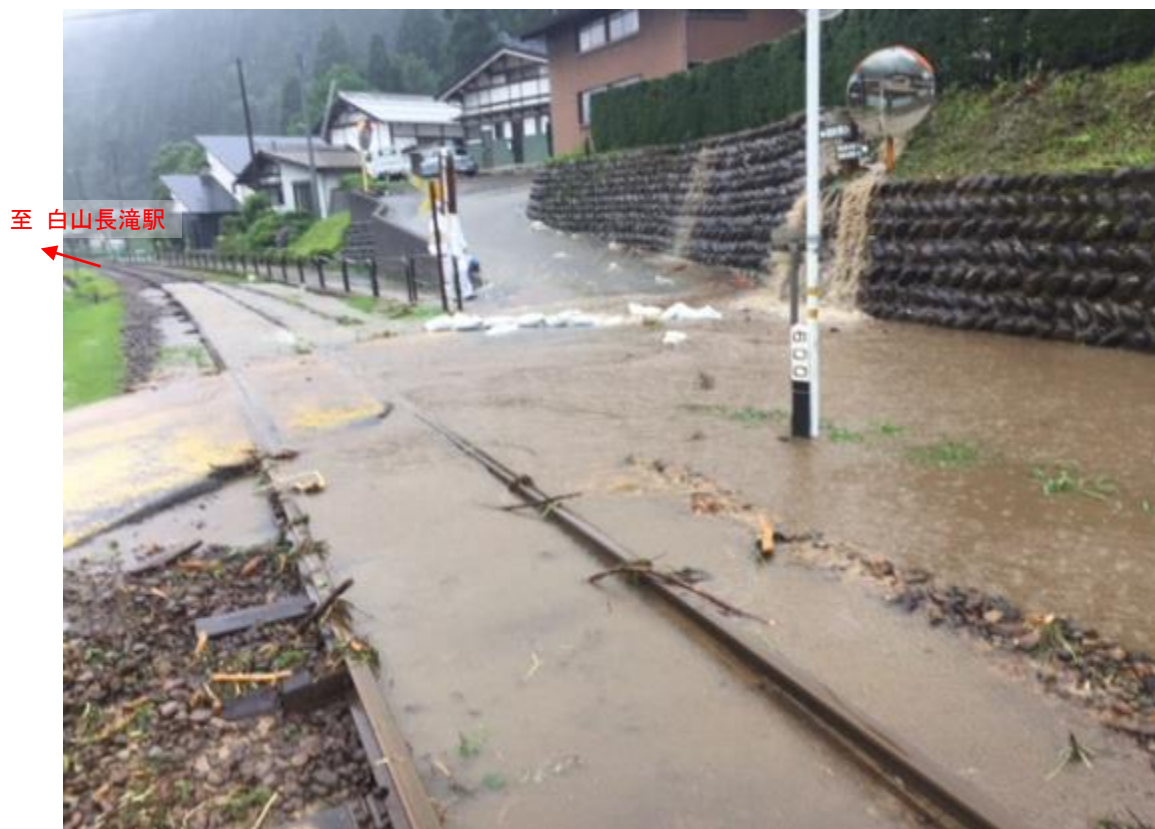
溢れた谷水により道床が流失（郡上市長滝地内）
