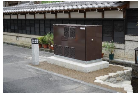
▲完成状況(地上機器)
