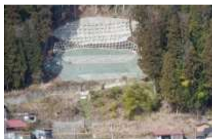
県単治山事業（山腹工） （県営特定農業用施設等災害復旧事業）
