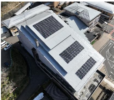
太陽光パネル
