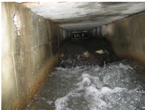
3-1-6 ゴミが詰まり水位が上昇した水路
