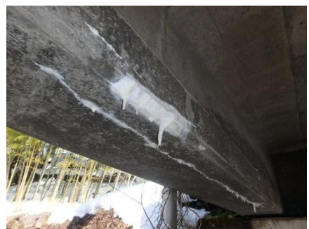
ひびわれ、遊離石灰
