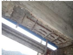
主桁の剥離、鉄筋露出
