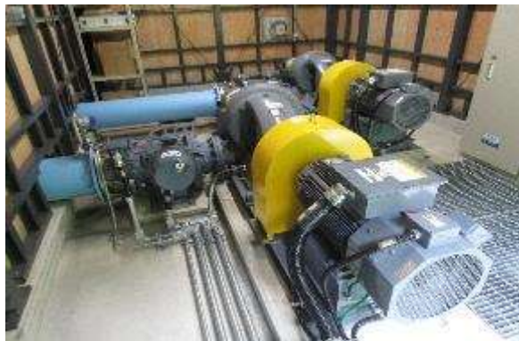
気良布平清流発電所
