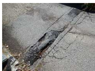
舗装ひびわれ、剥離
