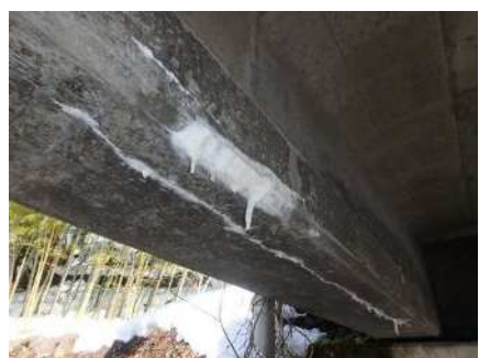
ひびわれ、遊離石灰
