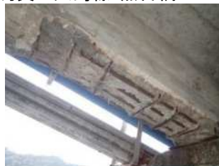
主桁の剥離、鉄筋露出
