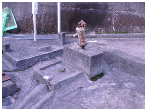
現在は利用されておらず、損傷の激しい井戸
