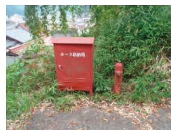
準公設消火栓（地上式）
