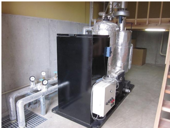
木質資源ボイラー
