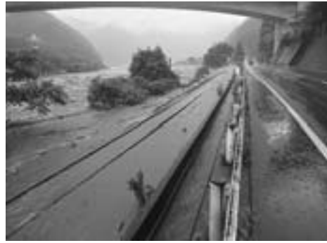
▲大雨により線路が冠水しました。
