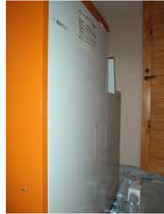
ペレットボイラー
