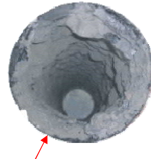
煙突内部に煤やタールが付着し、煙の通り道が狭くなっている。安定した排気が期待できなくなる。
